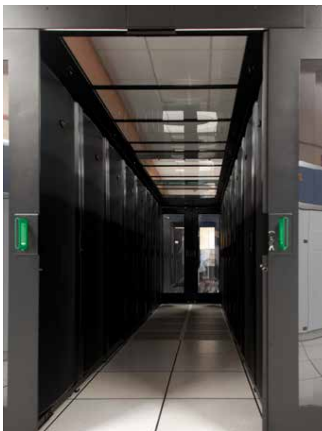
Confinement des allées froides
